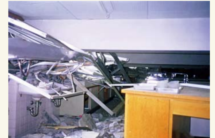
教室内の状況(上階床の落壊)
