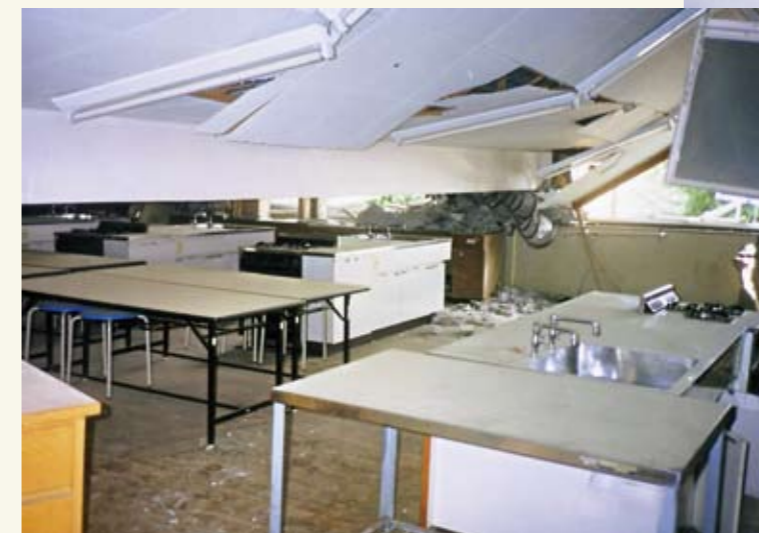
教室内の状況(上階床の落壊)
